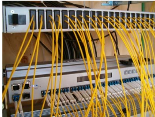
Fiberparen ur ODF med lång kabel till ASR
